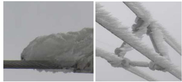
(c) Mixed snow and glaze icing (d) three bundled-conductors
